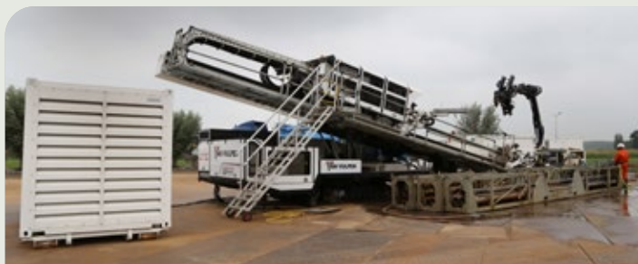
Van Vulpen heeft het aangedurfd en Oasen heeft het lef gehad om 2,3 kilometer DN700 sleufloos aan te brengen met elektrische boormachines.
